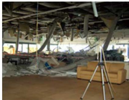
Campionamento dopo il crollo di una copertura
